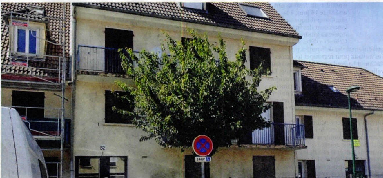
Jusqu'à nouvel ordre, deux locataires doivent vivre les fenêtres fermées en attendant des travaux de soutien de leur balcon.
