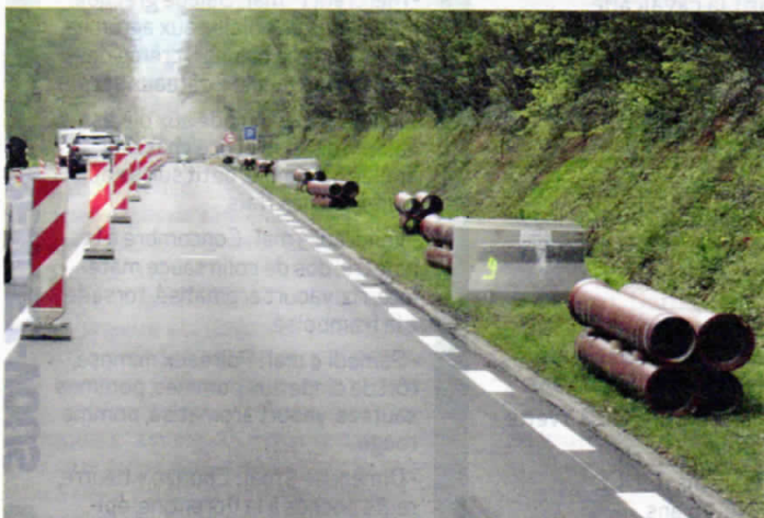
Depuis le 15 avril la circulation est alternée sur la RD 1001, entre Noailles et Sainte-Geneviève, afin de relier les communes au réseau d'assainissement.
